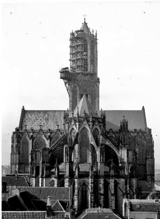
De Domtoren in de steigers tijdens de restauratie die Nieuwenhuis en Cuypers van 1899 tot 1919 samen uitvoerden, circa 1910. Op de voorgrond de Domkerk, met op het koor het lessenaarsdak dat Nieuwenhuis aanbracht ondanks de heftige protesten van Cuypers in 1881. [HUA / 82989]
