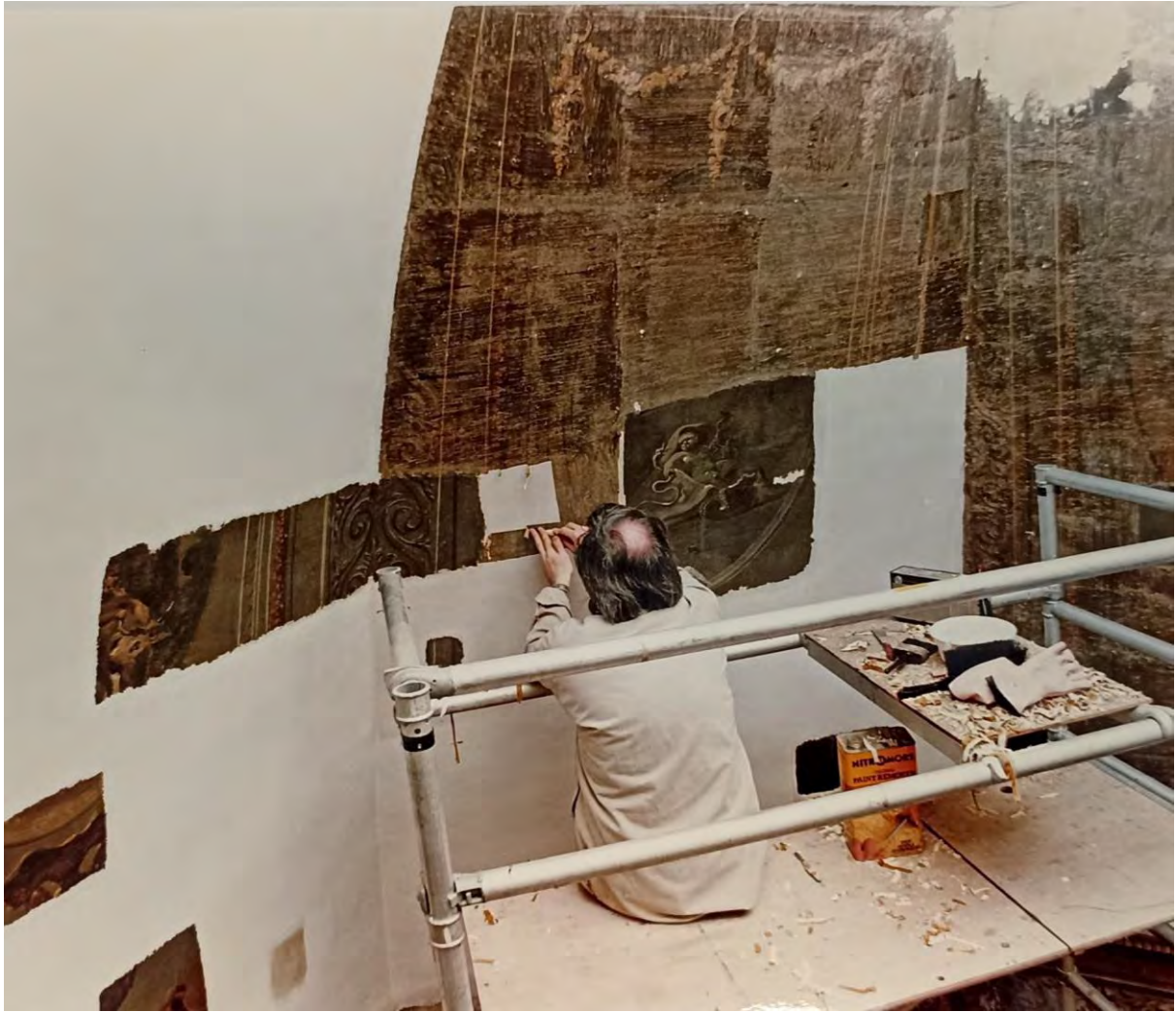
Afb. 57 Restauratie van de koepel van Hopetoun House (Foto: collectie Historic Environment Scotland).
