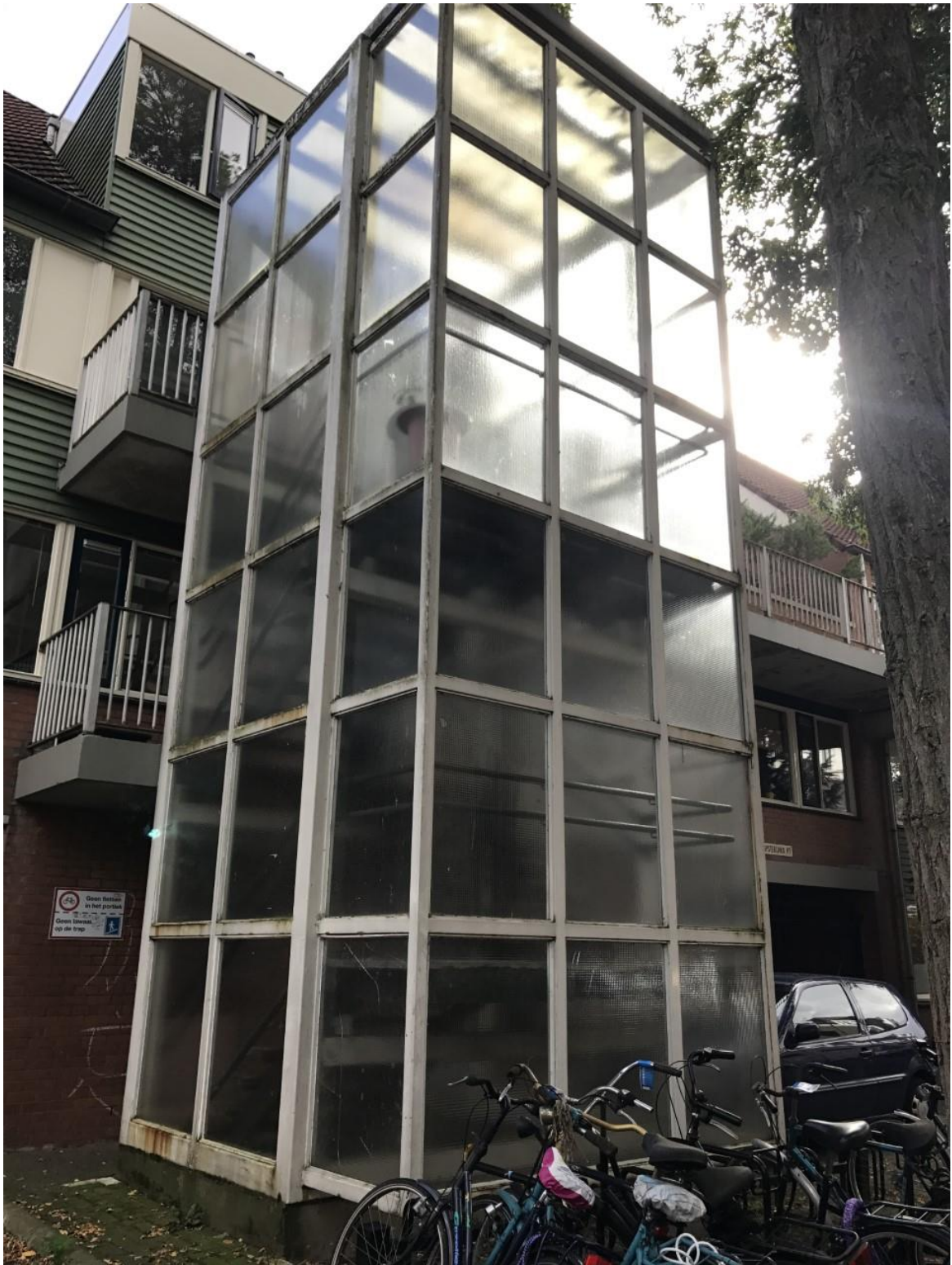
Foto 3 is een foto van een trap bij een flat. Er zitten barsten in de ramen en deze zijn groen aangeslagen. Deze trap kan wel een renovatie en grote schoonmaak gebruiken.
