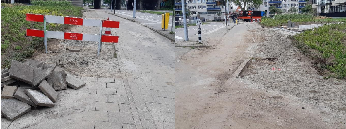
Figuur 3.13: Opgebroken trottoir te Ondiep, Utrecht.
