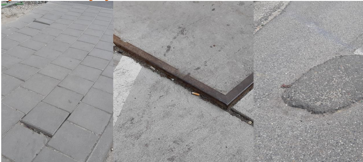
Figuur 3.15: Slecht aangelegde en/of onderhouden trottoirs in Utrecht.
