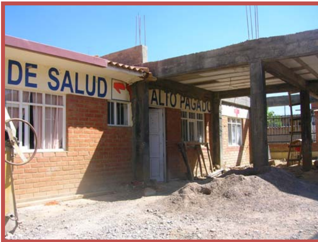
Foto 6: Het Centro Alto Pagador. De helft van het gebouw is onder constructie
