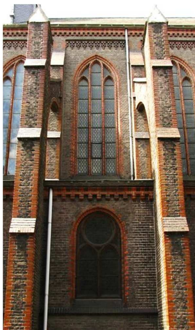
Afb. C.33 Eén travee van het schip, met verschillend getraceerde spitsboog- vensters in licht- en zijbeuken
