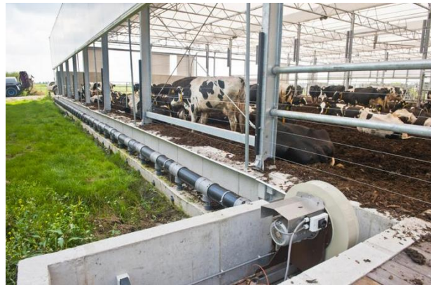
De slakkenventilator en buizen aan de zijkant van de stal.
